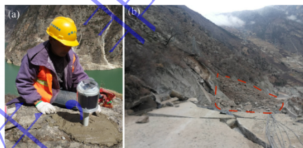
图 7 设备安装场景与现场垮塌现象
