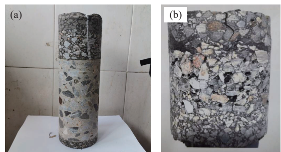
图 20 复合式路面 Top-Down 裂缝芯样. (a) 长潭高速公路; (b) RIOHTrack
